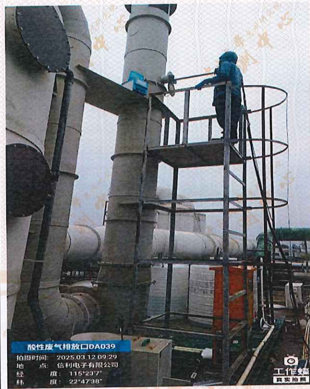
酸性废气排放口DA039
