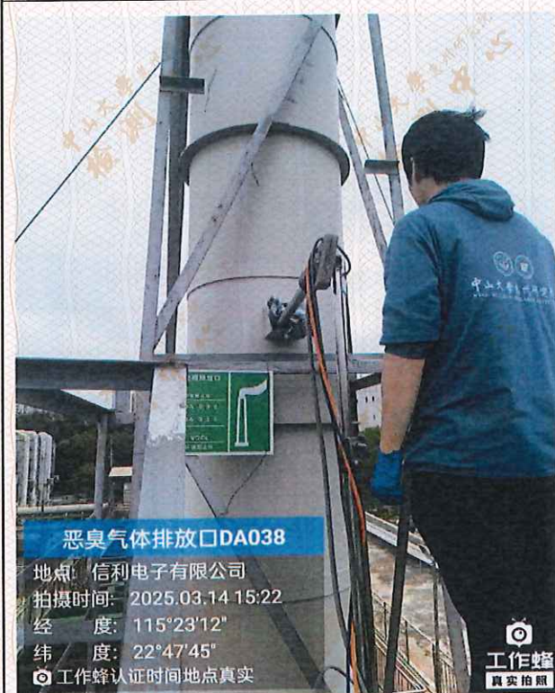
恶臭气体排放口 DA038
