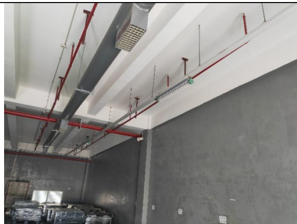
红草园区危险废物仓库废气收集系统
