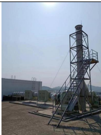
有机废气处理系统
