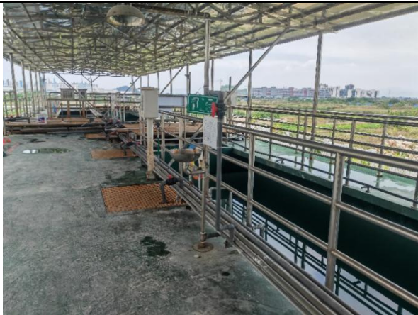
2 号废水处理站含氟废水处理系统
