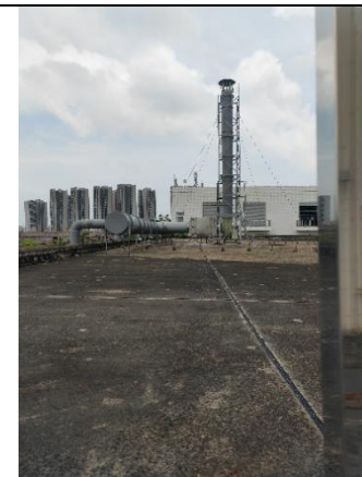
红草园区危险废物仓库废气处理系统
