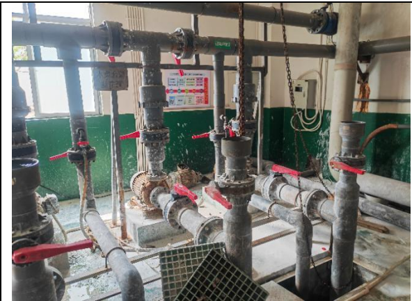
4号废水处理站综合废水调节池
