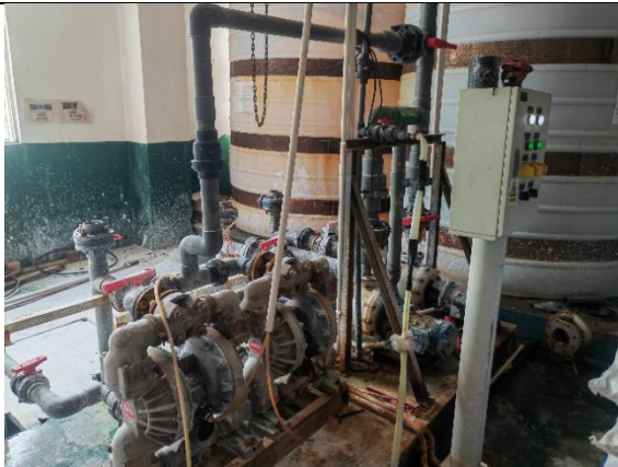
4号废水处理站含氟废水调节池
