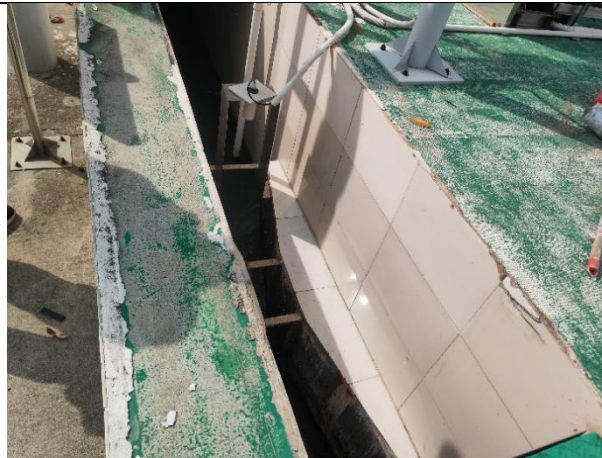
4号废水处理站排污口
