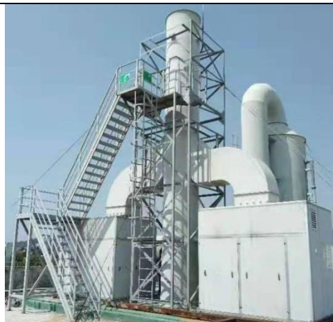
项目废气处理装置喷淋塔
