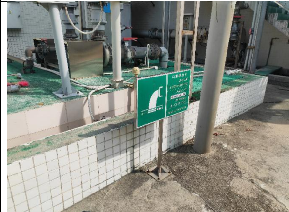
4号废水处理站排放口标识牌 (DW002)
