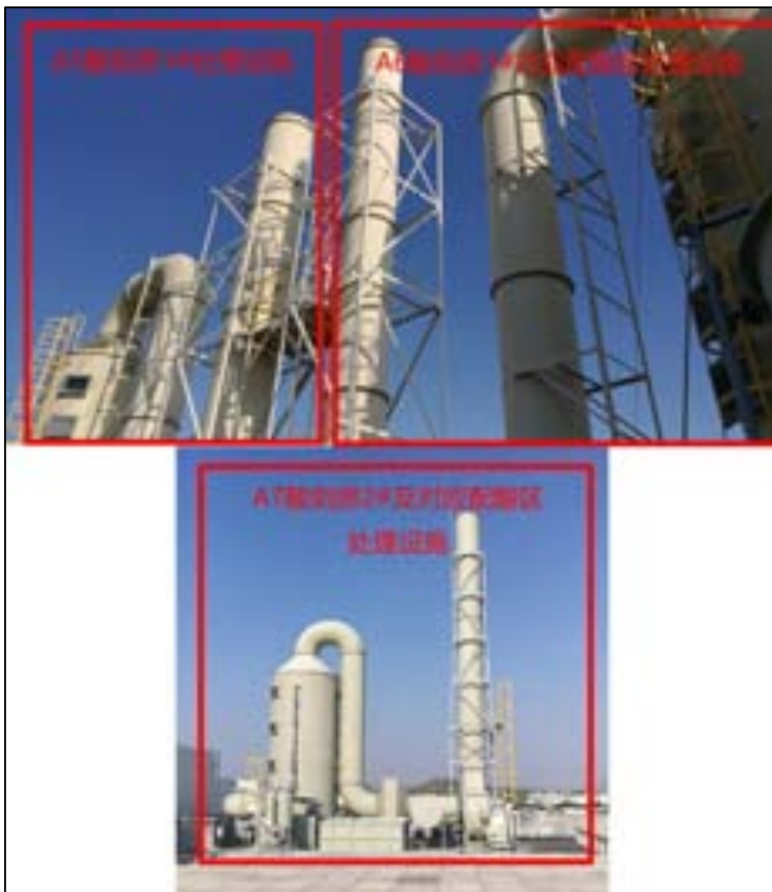
图 4.1-4 酸性废气处理设备现场照片
